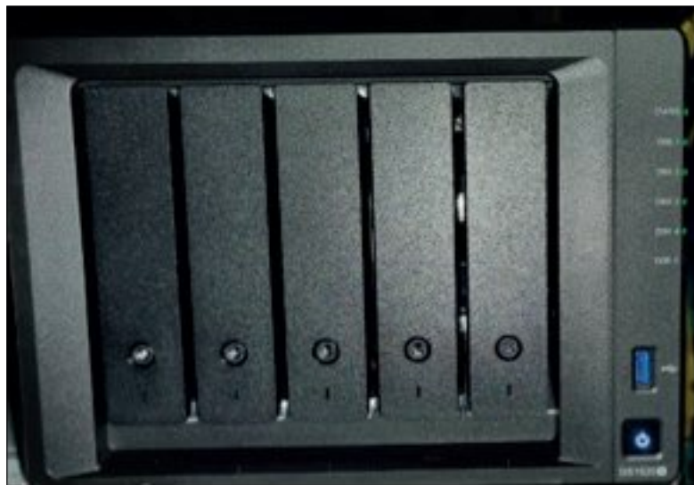
Gambar NAS Storage yang dipasang di Bilik Server IT
